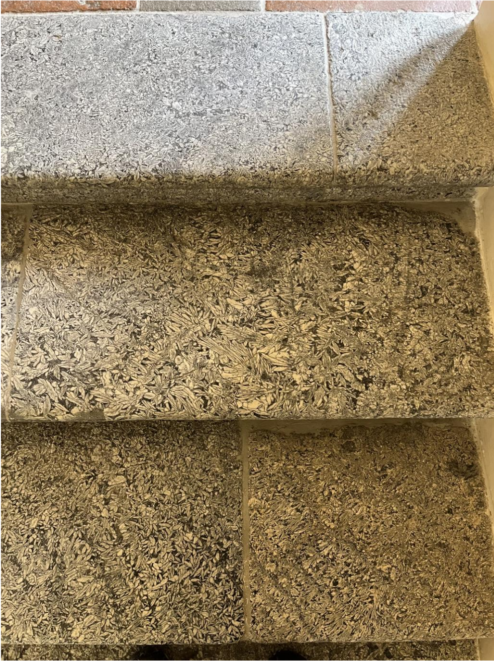
Verarbeitung von „Spatmagnetit“ als Treppen im Stift Admont; Foto: W. Lenhardt, GeoSphere Austria
